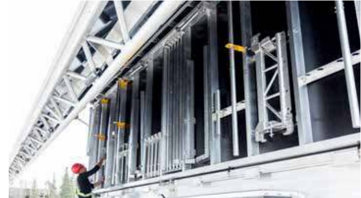
ENTREPOSAGE Système de stockage sur mesure sous le plancher pour les composants de la scène.
